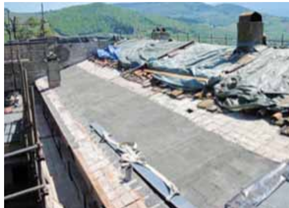
Das Dach des Mutterhauses der Schwestern nach dem letzten Stand der Arbeiten
